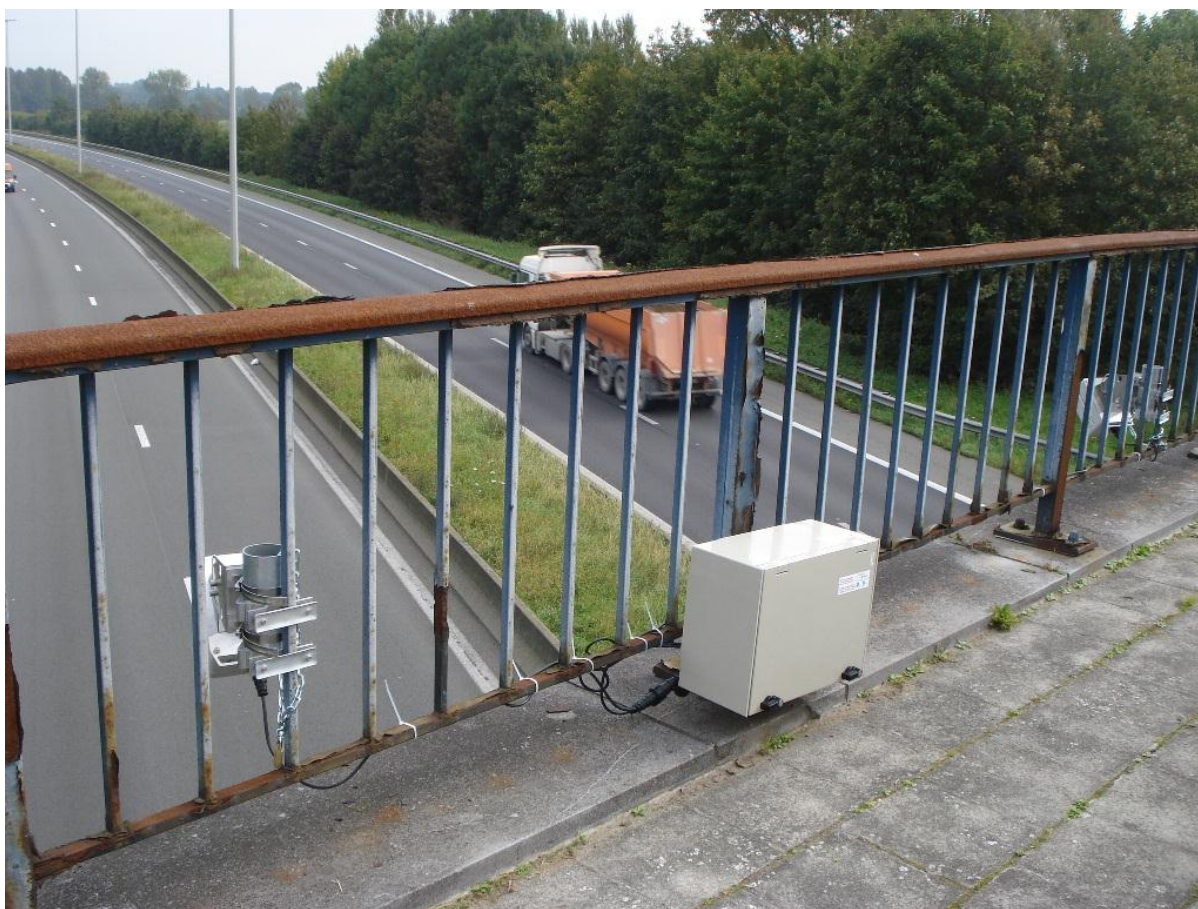
Figure 1 : Dispositif de comptage sur un site à Destelbergen (Flandre Orientale).
